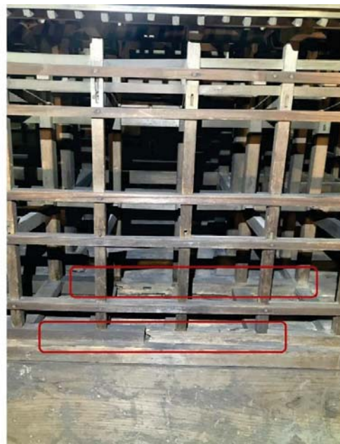
「東博模型」土台修理の痕跡など
