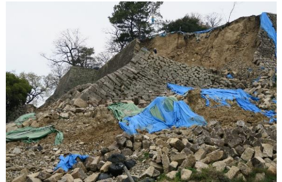
豪雨による石垣の崩壊
