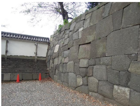
変形した石垣（現在は解体修復されています）
