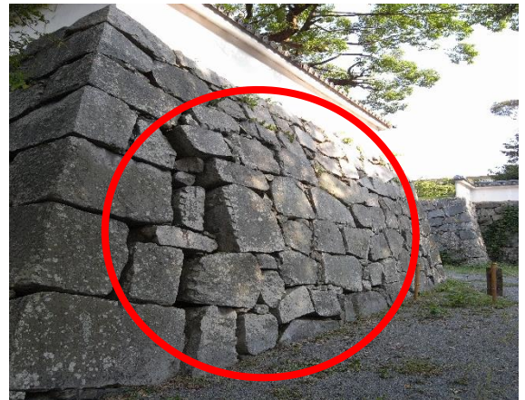
地震で大きく変形した石垣 (現在は解体修復されています。)
