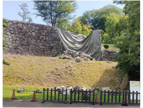
金沢城玉泉院丸口付近石垣崩落箇所
