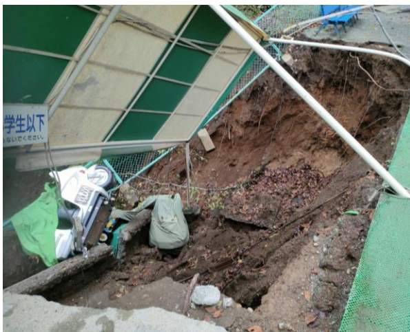
小田原城崩落箇所 こども電車の前 遊具と券売機崩落
